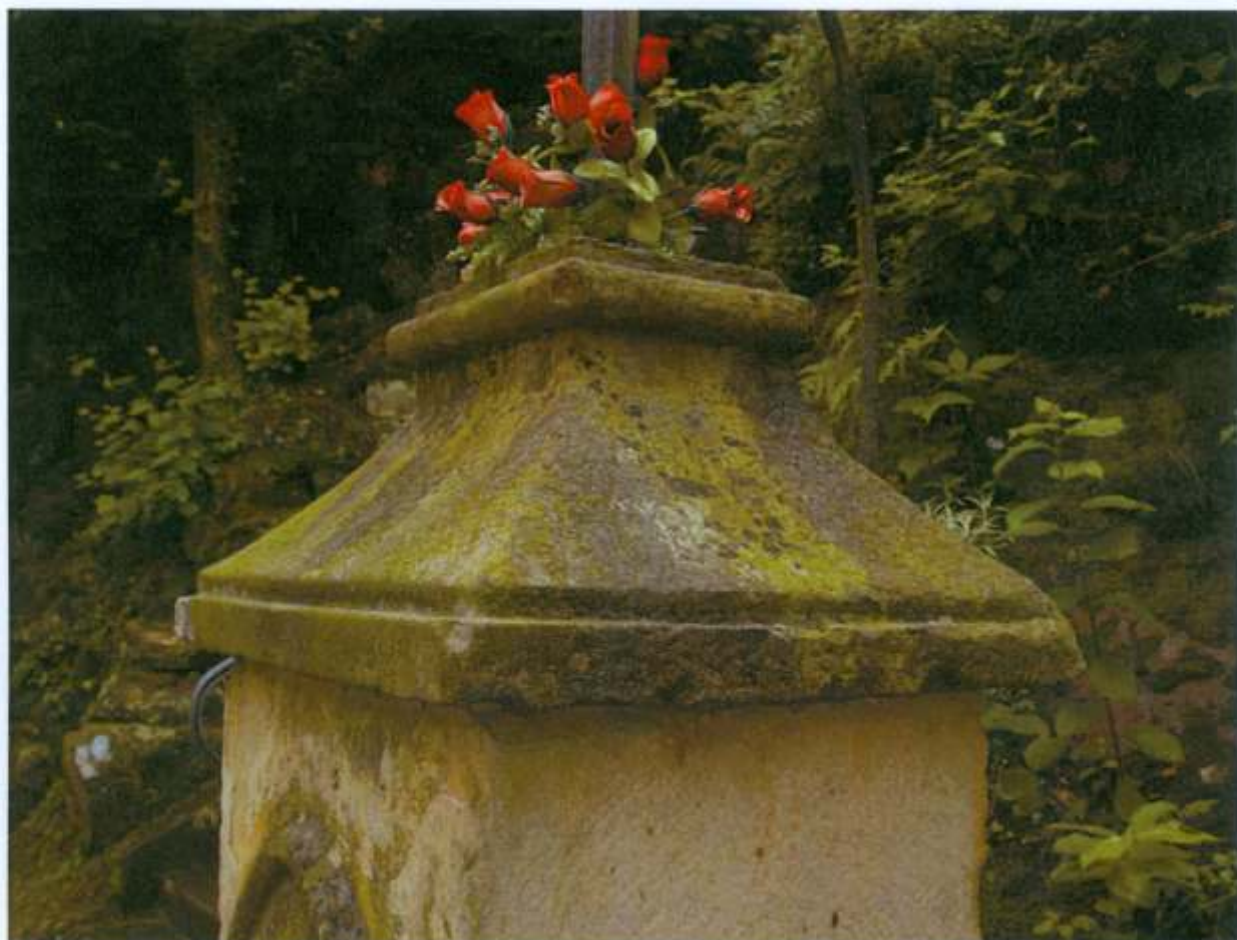
Krycí deska, pravá třičtvrťka – stav před restaurováním
