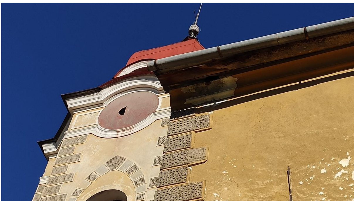
Obr.10 – Poškodenie omietok korunnej rímsy zatekaním pod dažďovým žlabom.
