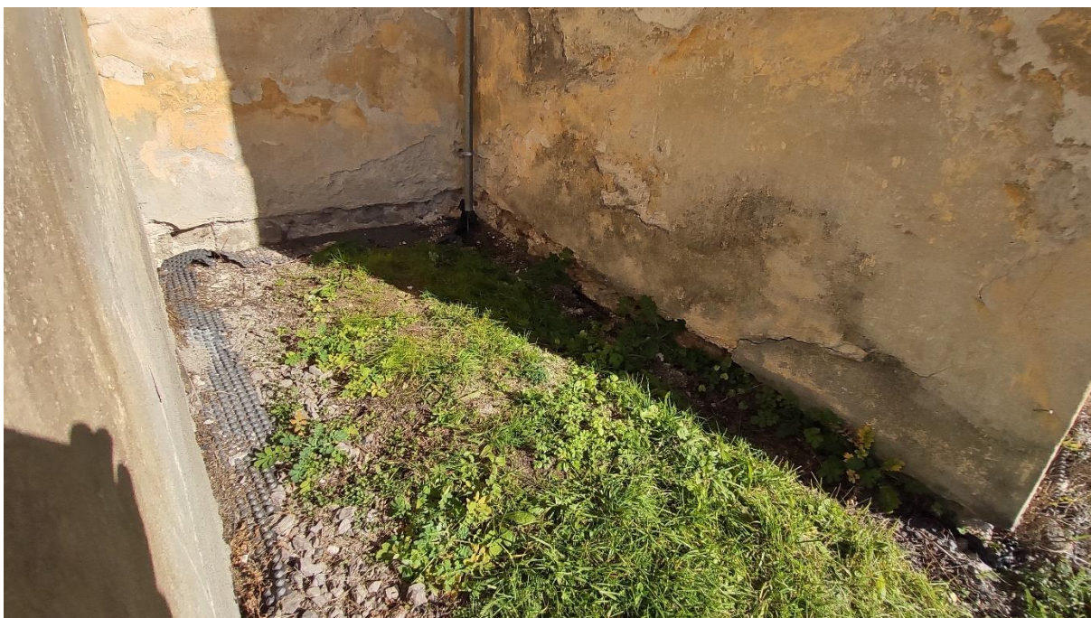
Obr.6 – Degradovaná omietka v spodnej úrovni v priestore medzi schodiskom a loďou kostola.
