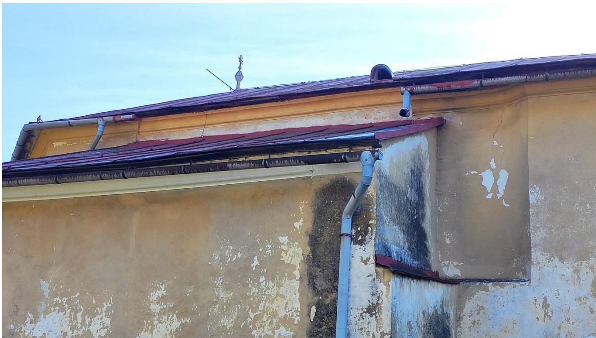
Obr.22 – Miesta kde preteká zrážková voda zo strechy na fasádu.
