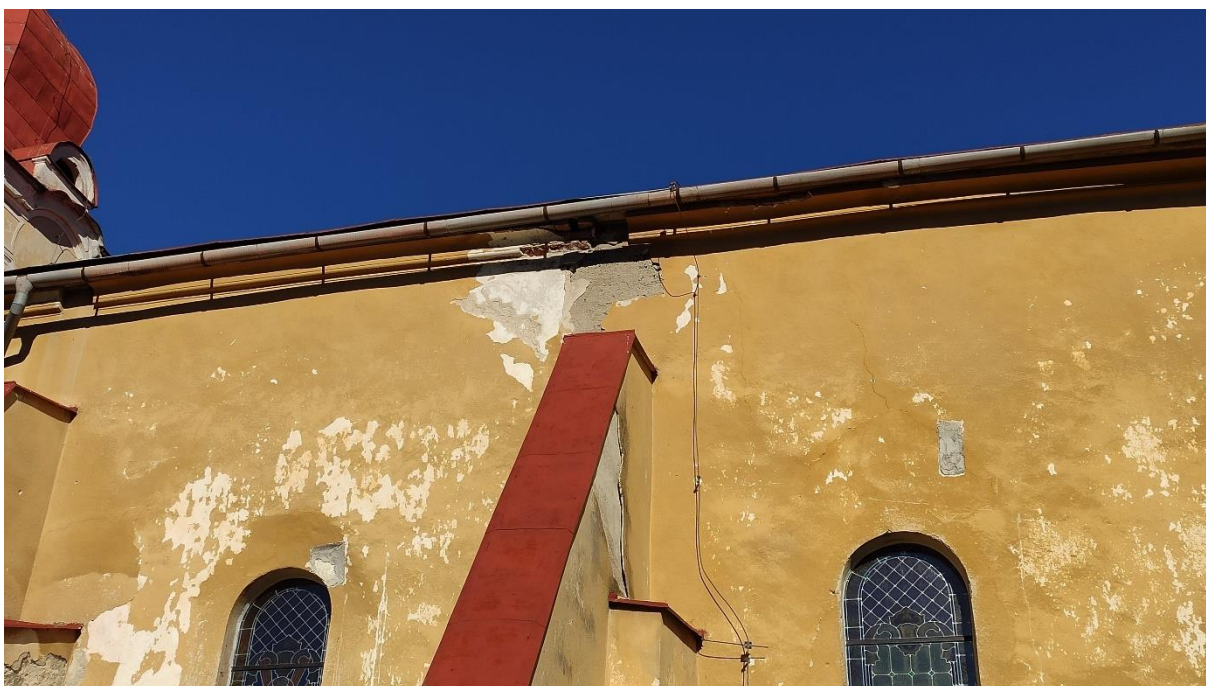
Obr.12 – Rozpad omietok v pozíciách zatekania z úrovne strechy.
