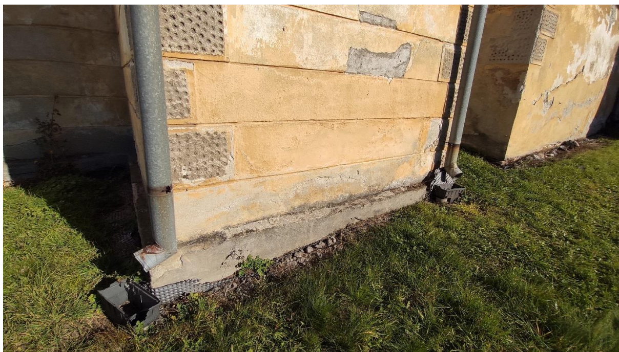
Obr.4 – Nevhodné stavebné úpravy realizované v minulosti.
