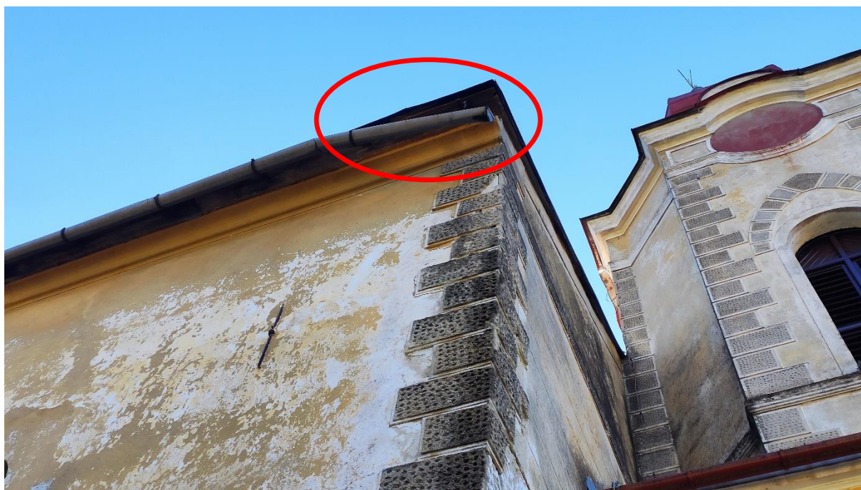
Obr.21 – Poškodený dažďový žľab.
