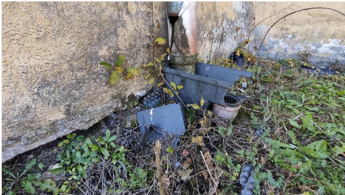
Obr.13 – Stav dažďového zvodu Z3.
