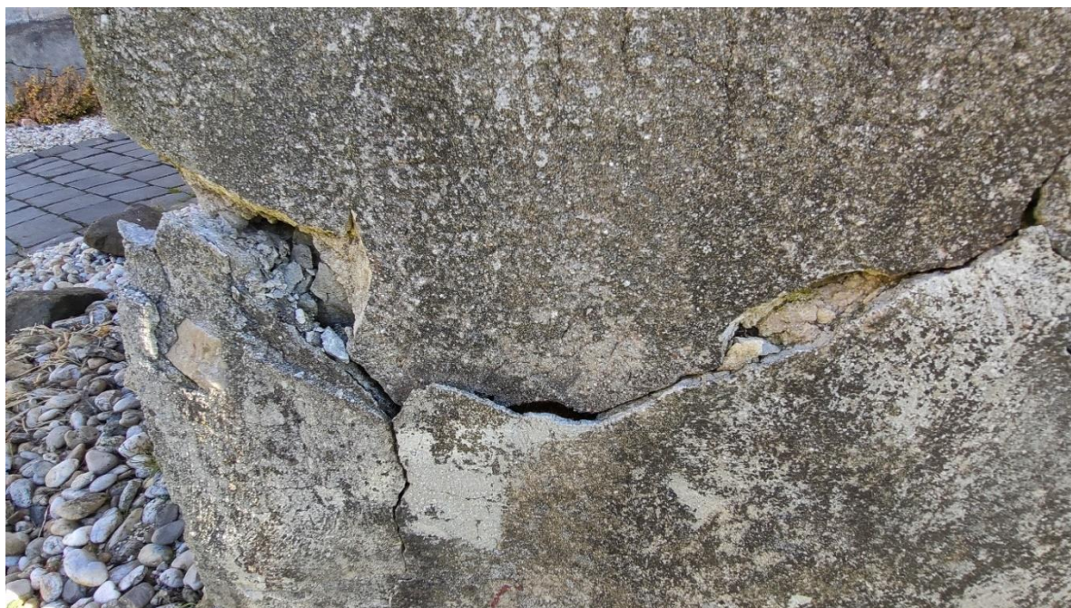
Obr.2 – Soklová omietka rozpadnutá pôsobením vlhkosti a mrazu.
