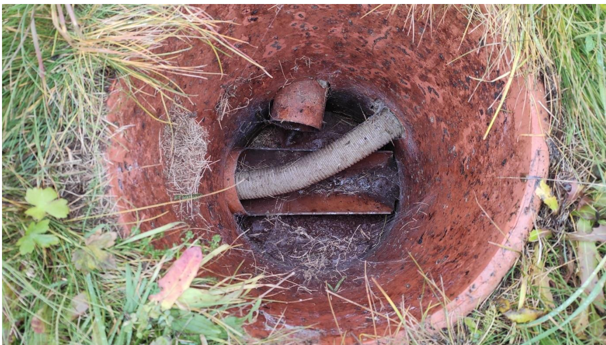
Obr.26 – Stav koncovej revíznej šachty SCH5.
