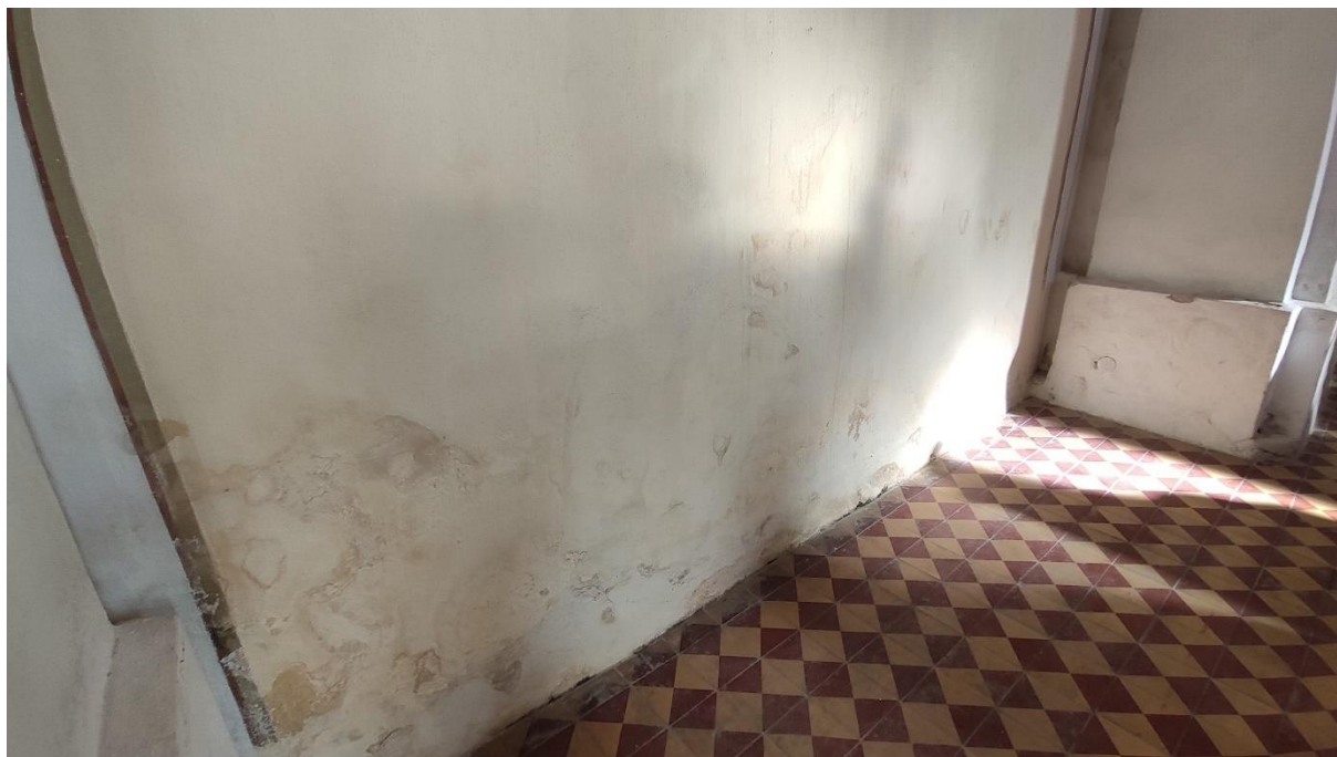
Obr.32 – Degradovaná omietka v spodnej úrovni severnej veže.
