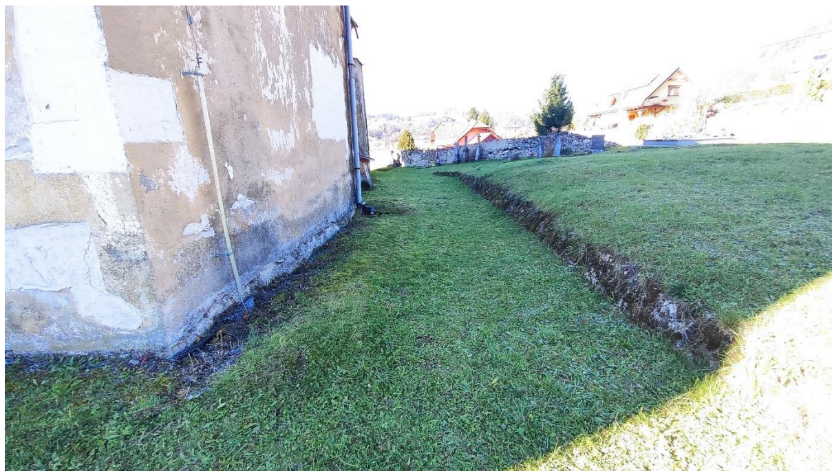
Obr.14 – Upravený terén na severnej strane s oporným múrikom bez riešenia odvodnenia.
