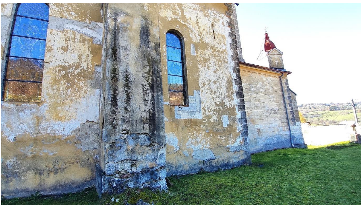
Obr.19 – Plochy fasády s biologickou koróziou a zmývaným fasádnym náterom.
