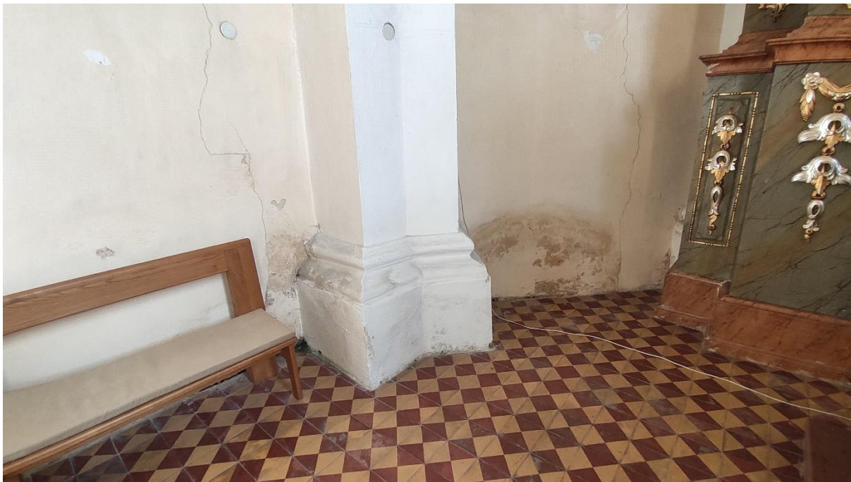
Obr.34– Vlhkostné mapy v interiéri v dôsledku dlhodobej dotácie vody zo zvodu Z3.
