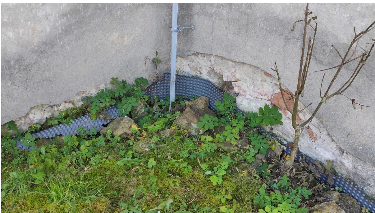
Obr.23– Nevhodne aplikovaná a časom úplne zdegradovaná nopová fólia.
