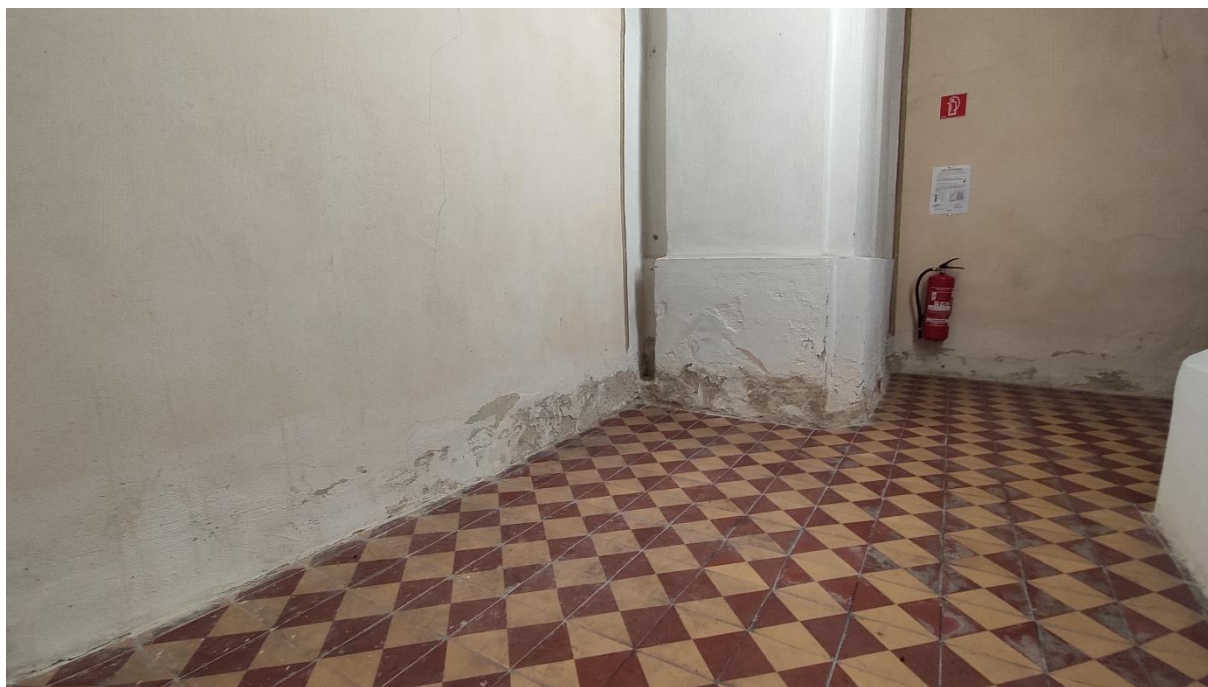
Obr.38 – Degradovaná omietka v spodnej úrovni nad podlahou cca 0,5-1 m.
