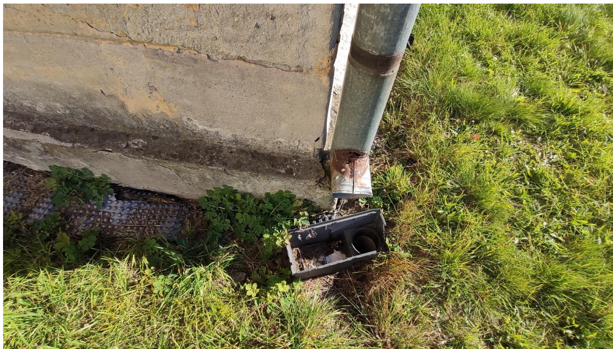
Obr.3 – Nevhodné ukončenie dažďového zvodu bez napojenia na lapač strešných splavenín.
