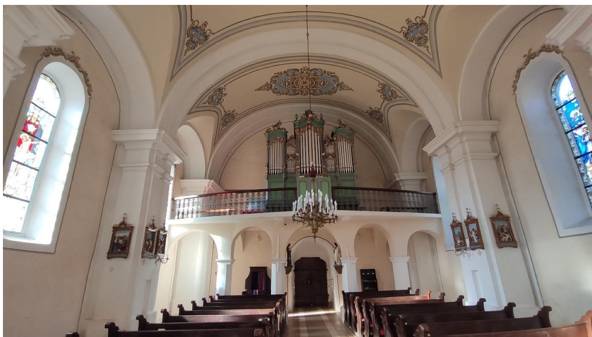
Obr.33 – Pohľad na stav omietok lode kostola.
