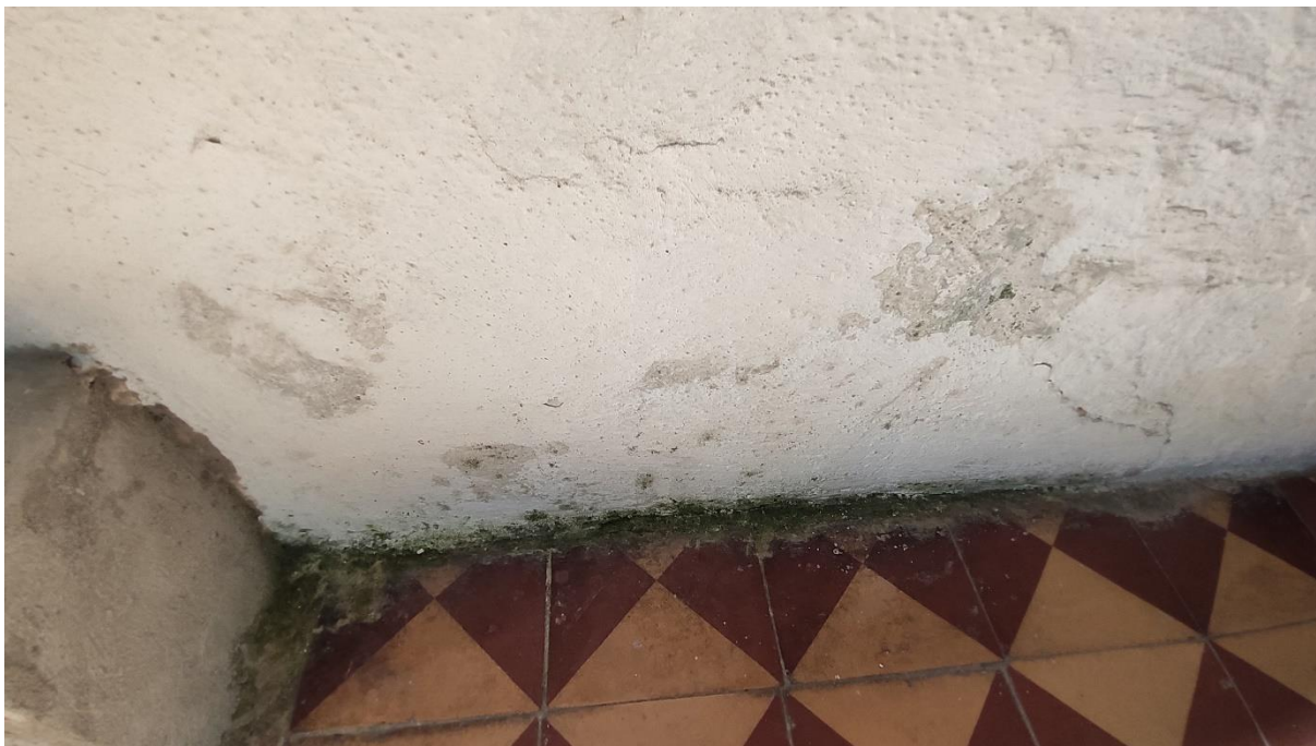
Obr.40 – Biologická korózia v škáre podlahy sakristie.
