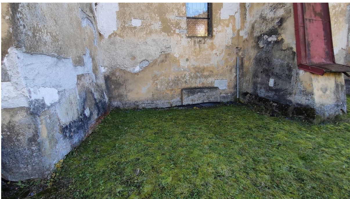
Obr.16 – Časť fasády v mieste zaniknutej kaplnky sv. Anny.
