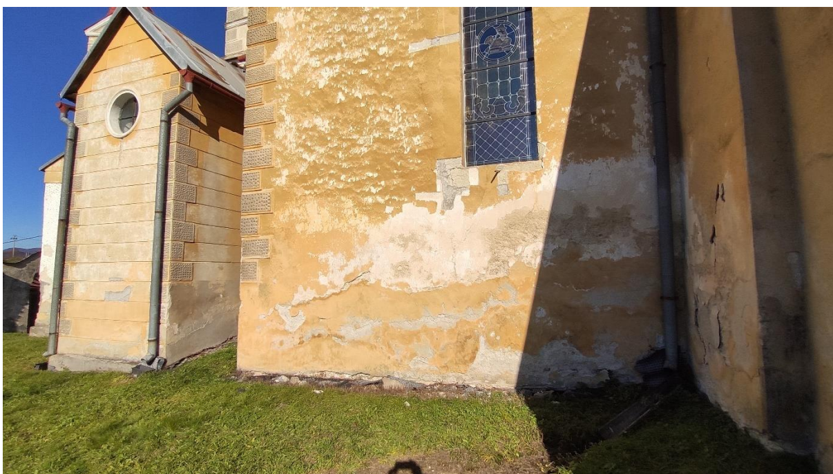
Obr.8 – Zvetrané a poškodené omietky na juhozápadnej strane lode.
