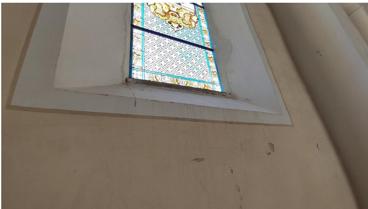
Obr.37 – Stekanie kondenzu po parapete okna v lodi kostola.
