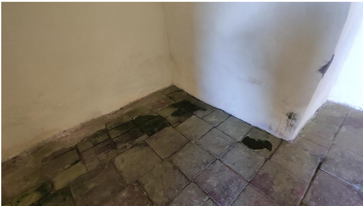
Obr.30 – Biologická korózia v miestach prienikov vody do násypu pod dlažbou.
