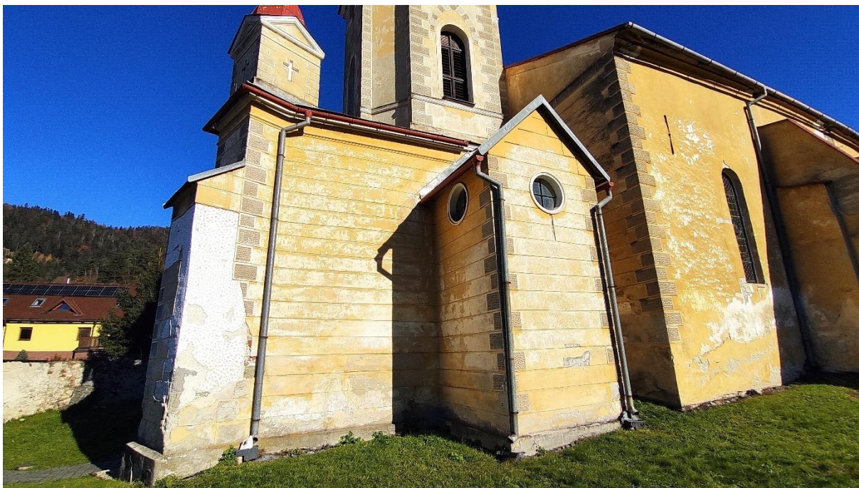
Obr.5 – Stav fasád na juhozápadnej strane (zmáčané plochy fasády).
