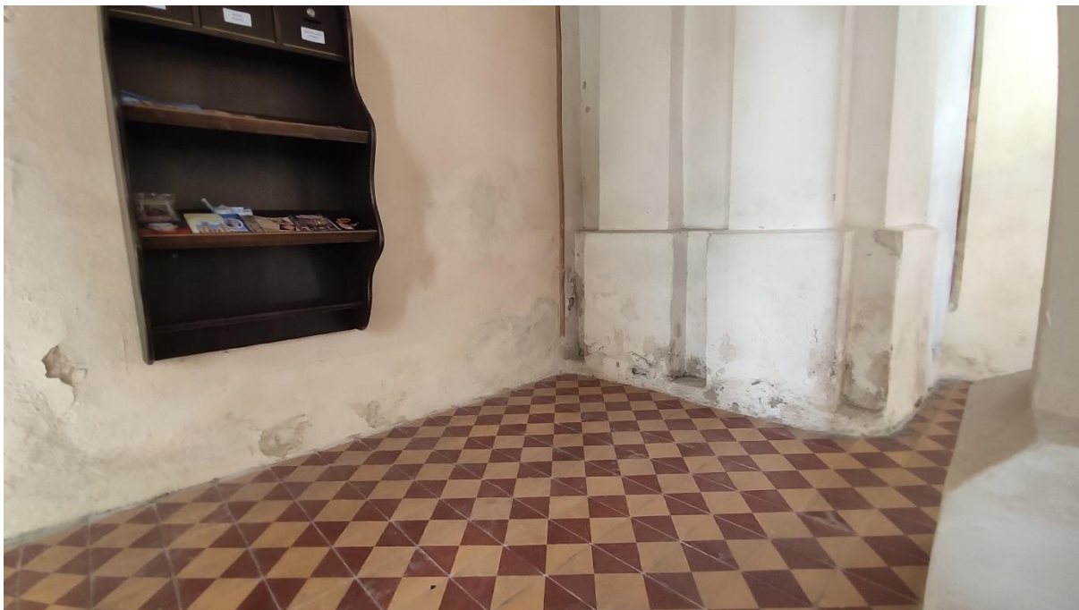
Obr.31 – Vlhkostné mapy a degradácia omietok nad úrovňou podlahy v lodi kostola.
