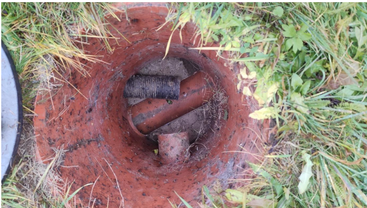
Obr.27 – Stav revíznej šachty SCH6 - bez známk odtekania vody.
