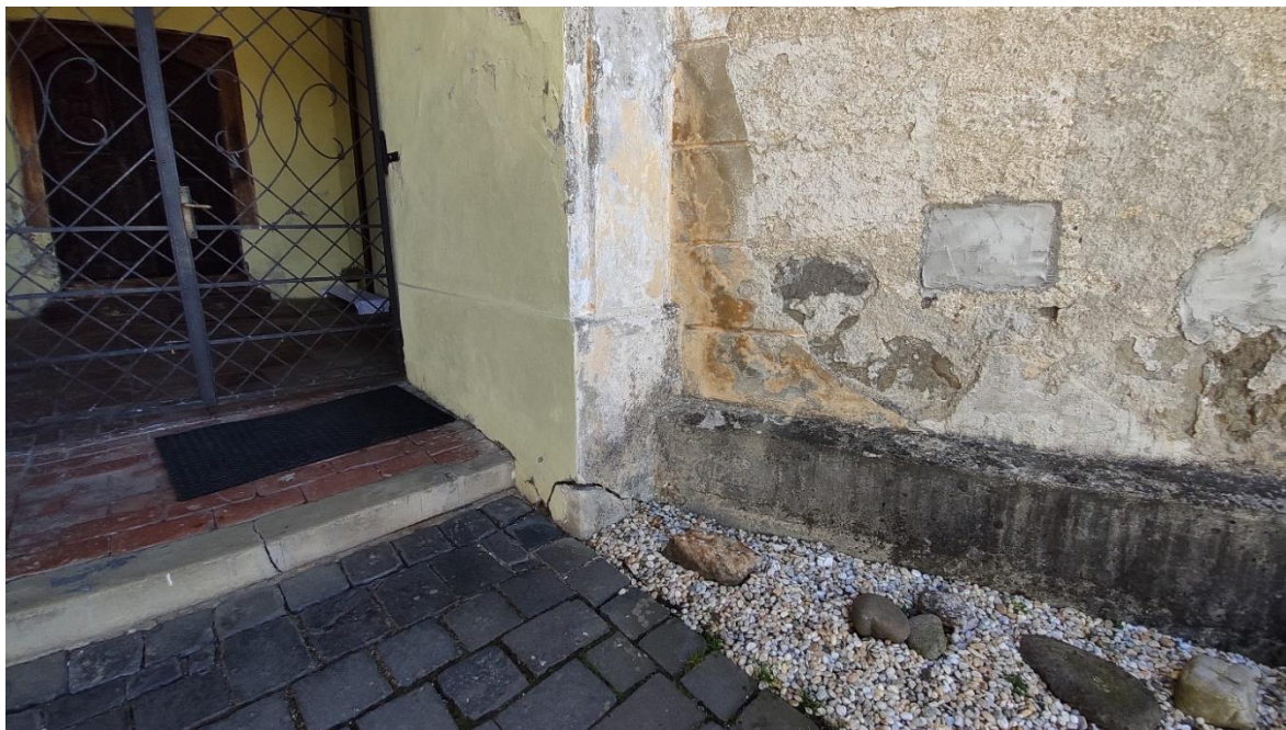
Obr.1 – Degradácia omietok nad úrovňou sokla z cementových omietok.
